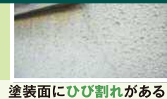
塗装面にひび割れがある
