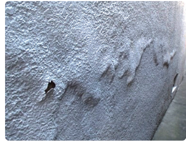
塗膜剥がれも怪しいサイン
