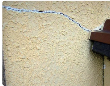
要注意な横方向のひび割れ
